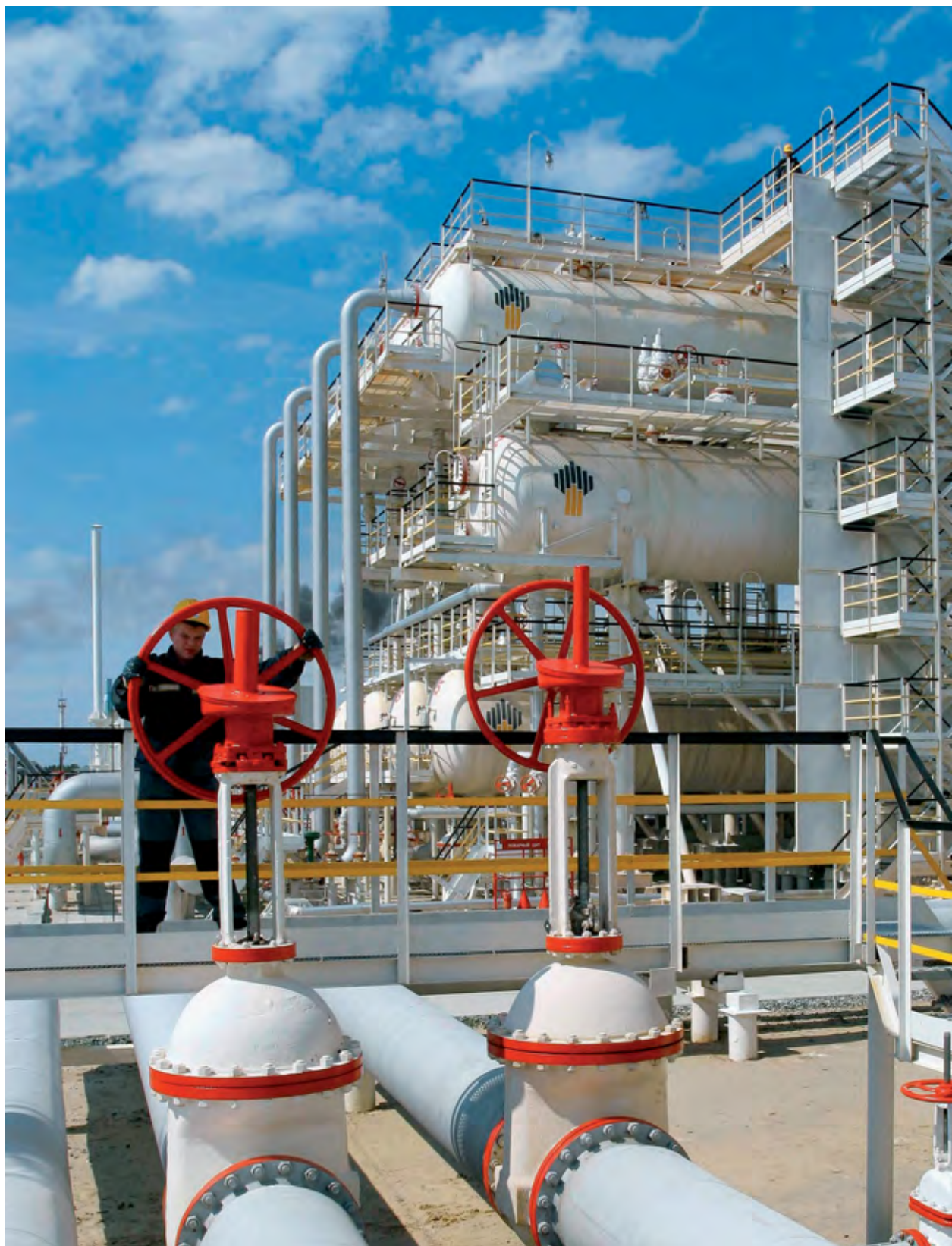
Сепарационная установка ЦППН-8 «РН-Юганскнефтегаз»
